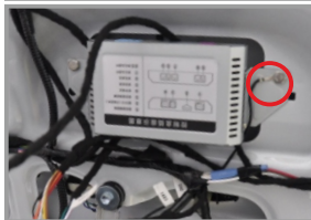
66. Вид установленного блока управления
